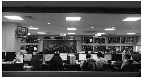
韓国大法院電算情報センター内の管制室
